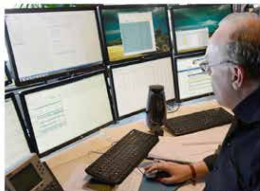
DSB's styrecentral på Hovedbanegården_7.jpg
